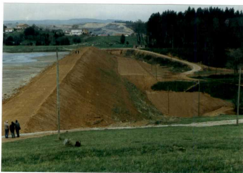
DETALLE CONSTRUCTIVO DEL DIQUE DE ESTERILES DEL POZO JAIME (FASE DE RECRECIMIENTO).
